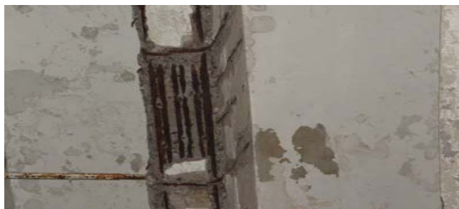
Рисунок 2 – Повреждения эксплуатируемых железобетонных конструкций
