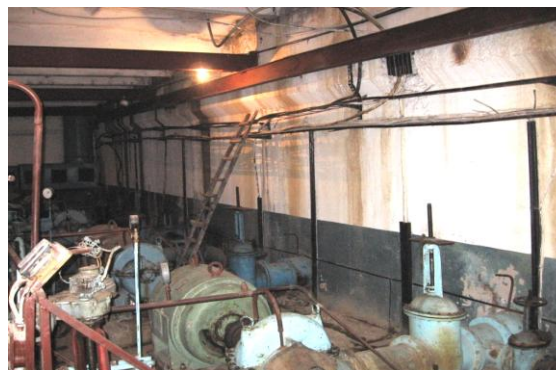
Рисунок 3 – Машинный зал насосной станции I-го подъема
